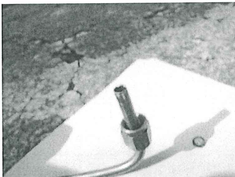
Fotografía No. 27 Vista de la fractura
